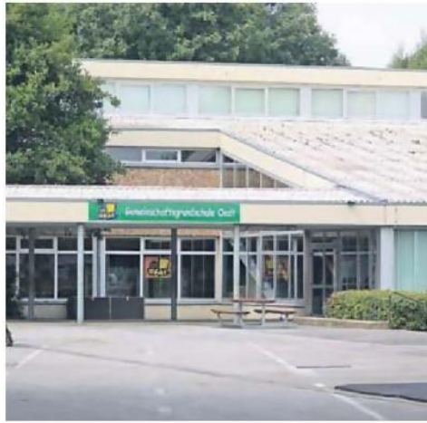
Etlliche Baumängel gibt es in der Oedter Grundschule. Sie können aus Kostengründen derzeit nicht behoben werden.
